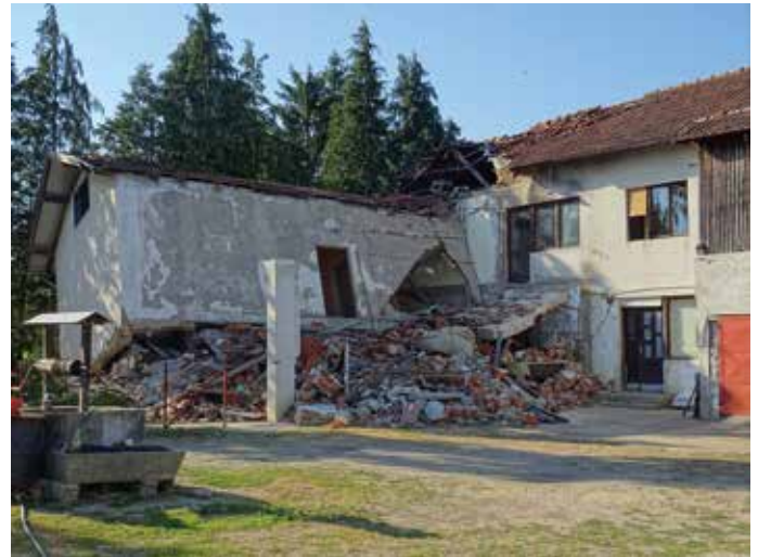
So sehen die zerstörten Häuser noch immer aus.
